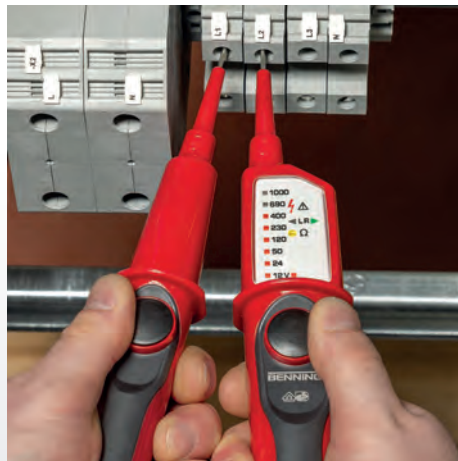
Drehfeldprüfung an den Ausgangsklemmen einer USV
