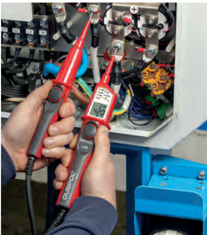
Prüfung der Ausgangsspannung einer DC-Ladeeinrichtung
