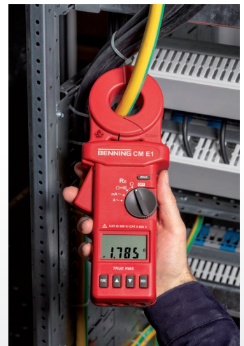
Messung des Betriebserders einer Industrieverteilung
