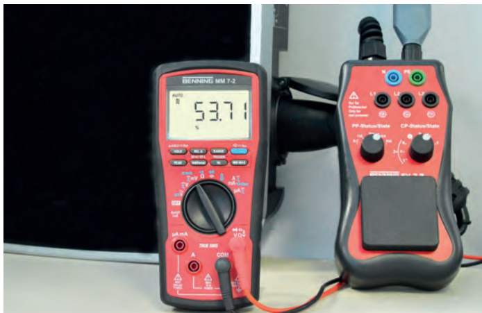
Tastverhältnismessung des CP-Steuersignals einer Wallbox
